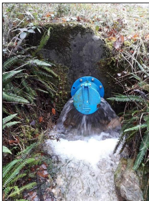
Trop plein le 30/12/2020
