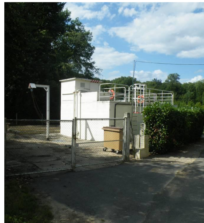
Station d'épuration des eaux usées de Pecqueuse
