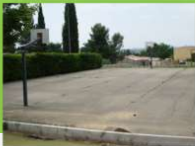
Terrain de basket au bitume abîmé
