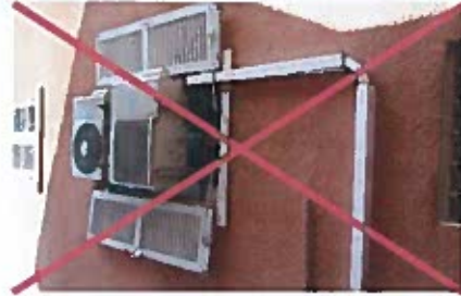
Appareillage de climatisation rapporté
