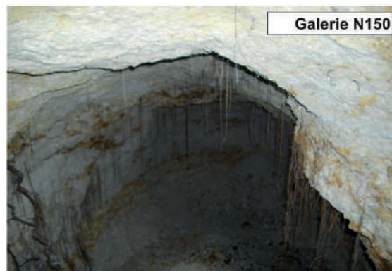
Effondrement sur la commune de Bruz en 2013
