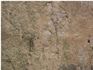
Ancien enduit gratté
