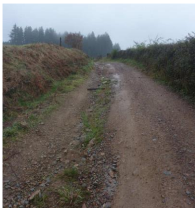
Chemin forestier à remettre en état
