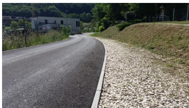
Figure 89 : Exemple d'infiltration des eaux de voirie dans les accotements
