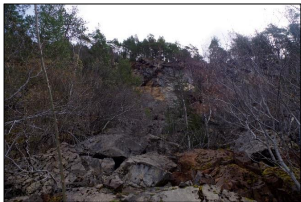
Photo 10 : Concession du Rancié – effondrement de grandes dimensions (D2) à proximité de la galerie Sainte-Barbe
