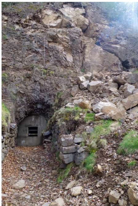
Photo 19 : Blocs < 10m 3 tombés au droit de la galerie St Barbe Rancié
