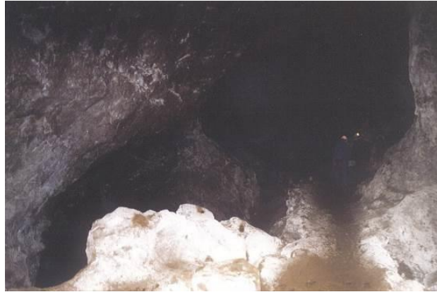
Photo 5 : Vide conséquent au niveau des travaux de l'Auriette (Photo datant de 2001)
