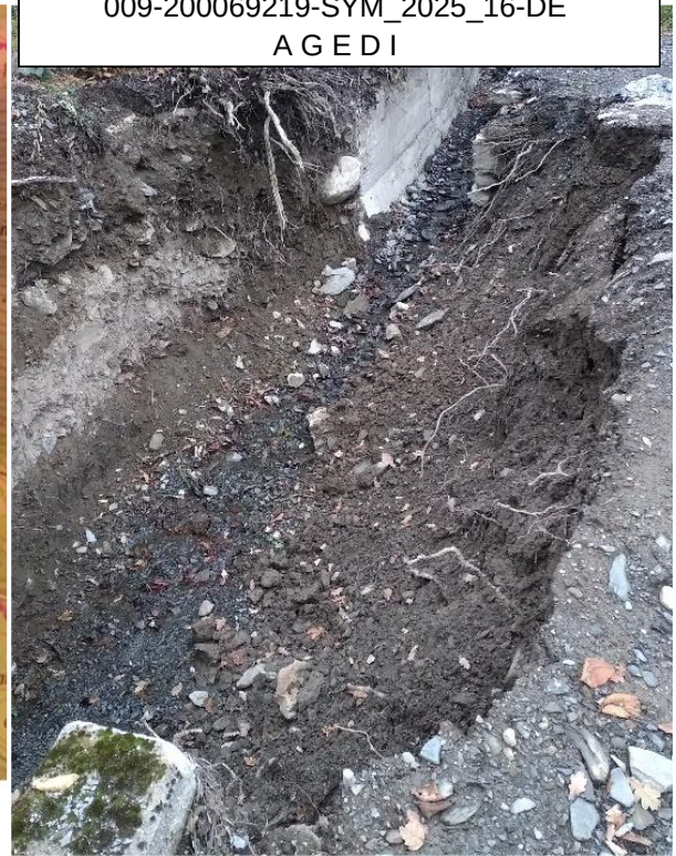
Figure 8 : Source fiche évènement du RTM - Photographie d'un mur privé emporté durant l'évènement
