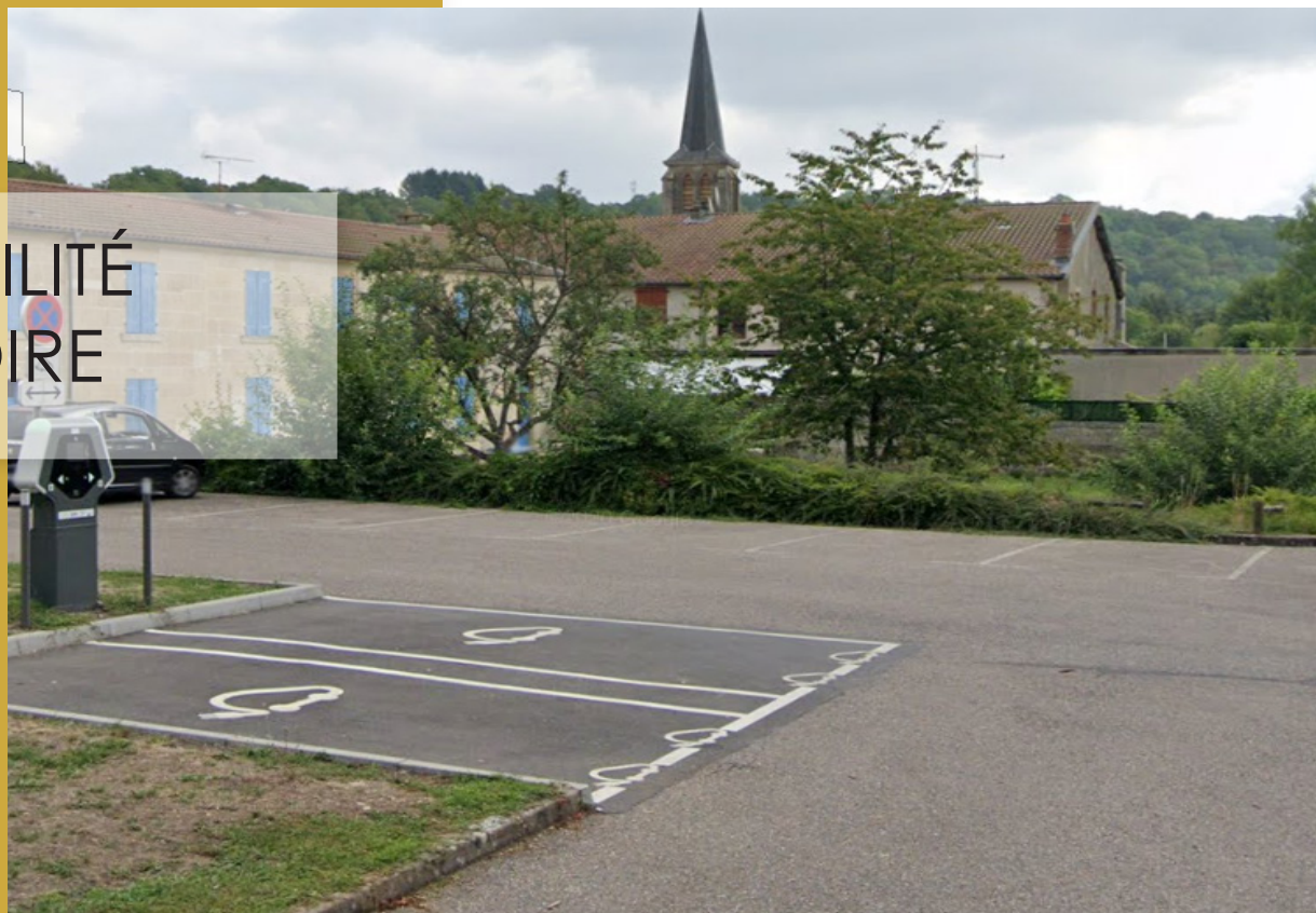
Source : NEGE Borne de recharge de véhicule électrique L'ISLE-EN-RIGAULT
