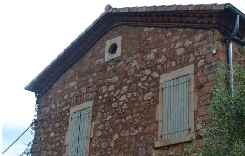
CHEMINEMENT DE FILS ÉLECTRIQUES QUI SUIVENT LES GÉNOISES
