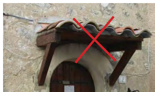
Auvent charpente bois interdit
