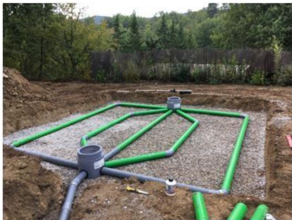
Filtre à sable
