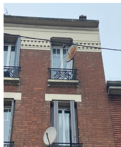
Présence d'éléments techniques (paraboles) nuisant à l'intérêt patrimonial de la façade
