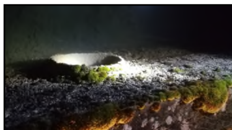
Exutoire du déversoir d'orages 1
