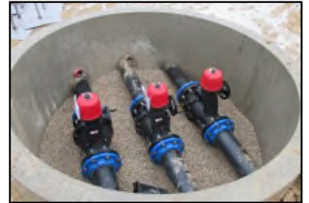
Dispositif de répartition automatique
