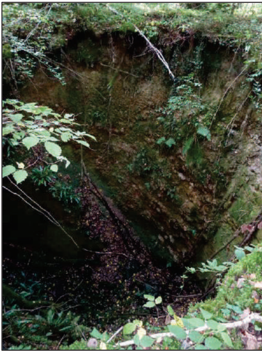
Photo 1 : Fontis Descenderie N°1 de Berdallier
