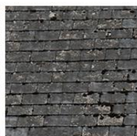
Fibrociment dégradé, Rosiers d'Egletons
