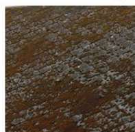
Fibrociment dégradé, Pêret-Bel-Air
