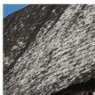
Fibrociment dégradé, Moustier-Ventadour
