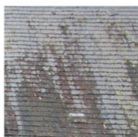
Fibrociment dégradé, La Chapelle Spinasse
