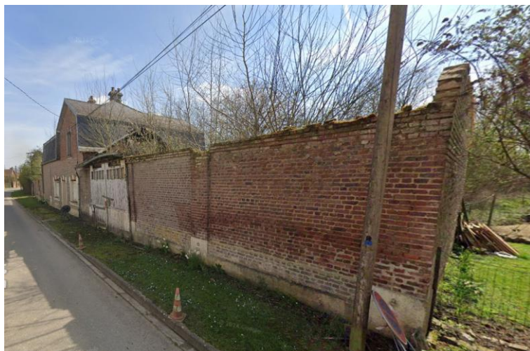
Bâti en friche à Vendelles
