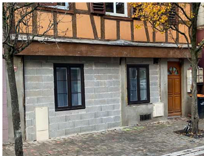
Matériaux contemporains non prévu pour être laissé apparent. (Bouxwiller)
