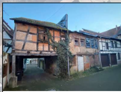
Immeuble abandonné au 5 Rue des Cygnes
