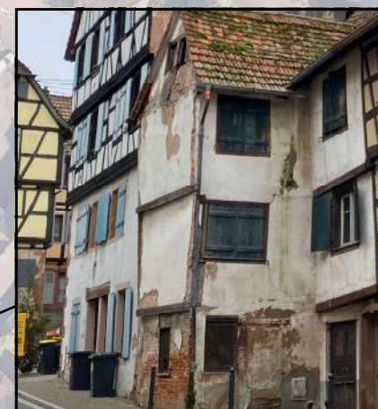
Immeuble vacant et très dégradé
