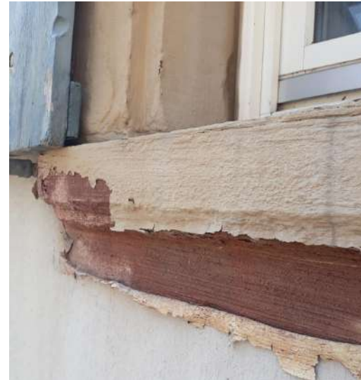
Peinture inadaptée sur grès.
