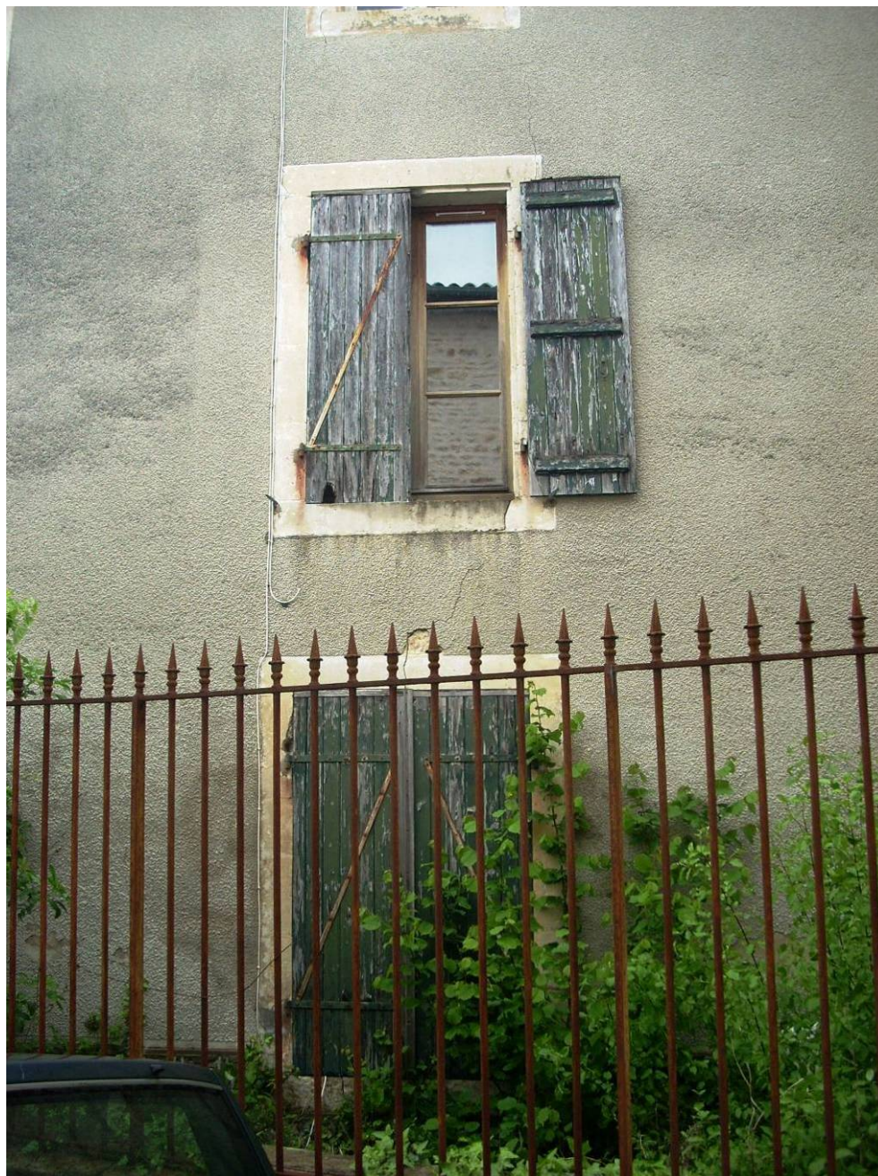
Photo 44 - Travaux Decemme : fissure dans la facade de la maison.
