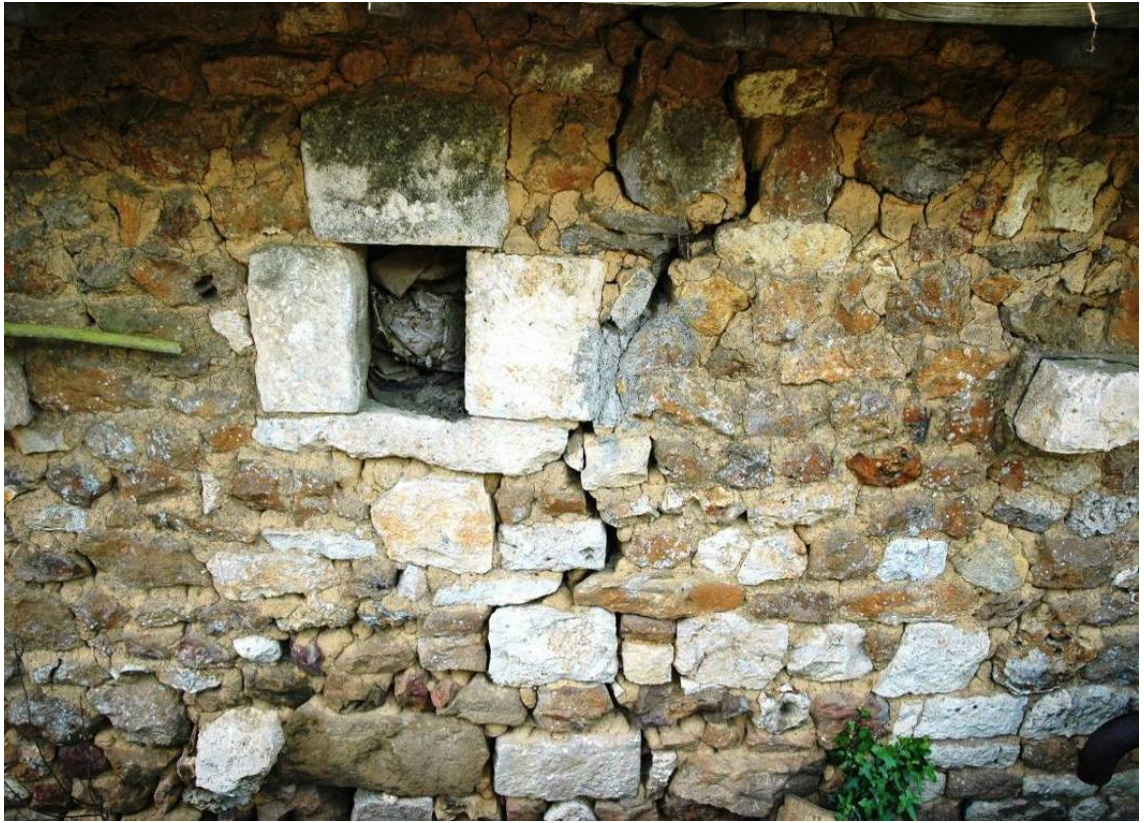
Photo 50 - Détail de quelques-une des fissures du garage de la photo 49.
