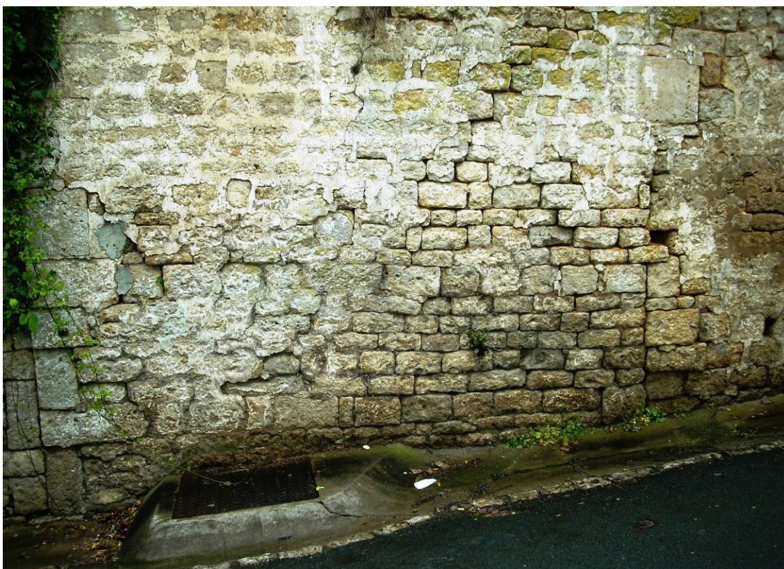
Photo 43 - Travaux Decemme : le mur de clôture fissuré de la maison, et la plaque d'accès P2 au réseau.
