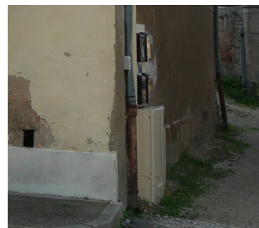
Coffret individuel de raccordement EDF.
