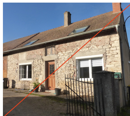
Disparition de l'enduit, reprise au ciment (Allerey-sur-Saône)
