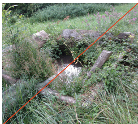
Lavoir abandonné, envahi par la végétation (Chatenoy-le-Royal)
