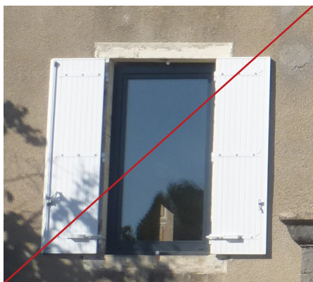
Simplification à l'extrême et appauvrissement du dessin de la menuiserie.
