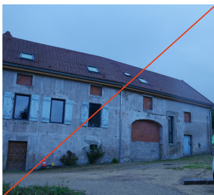
Modification peu cohérente des baies (Saint-Léger-sur-Dheune)
