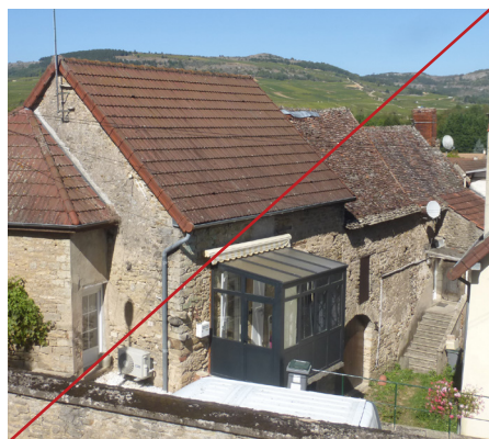
Pose très visible d'un matériau différent rompant l'homogénéité des toitures.
