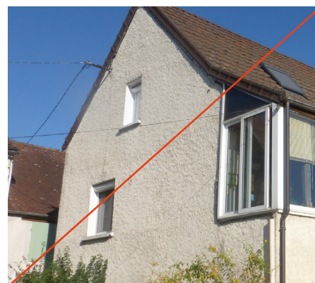
Modification de la charpente et crépi rapporté (Bouzeron)
