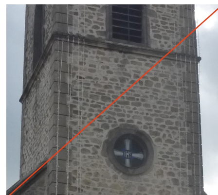
Disparition des enduits couvrants (Saint-Bérain-sur-Dheune)
