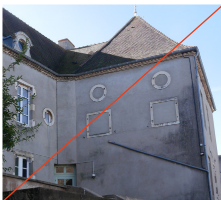
Enduit ciment et baies murées (Sassenay)
