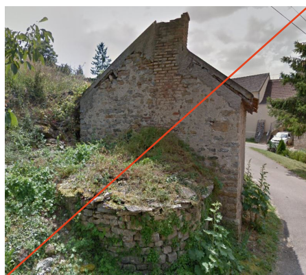
Four très délabré ayant perdu sa toiture (Saint-Gilles)
