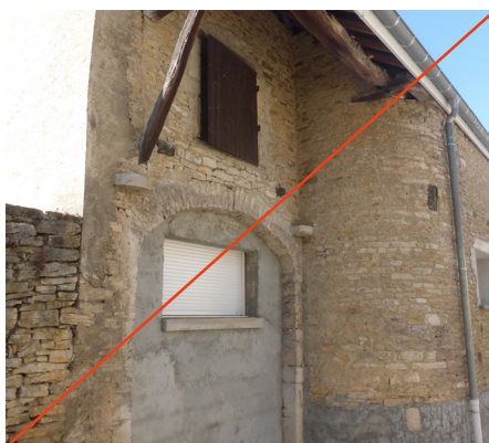
Menuiserie inadaptée à la baie (Remigny)
