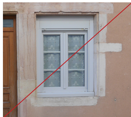
Sur-épaisseurs des différents cadres réduisant considérablement la partie vitrée.
