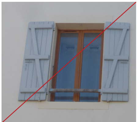
Contrevent à écharpe en 'Z', garde-corps de fenêtre bricolé.
