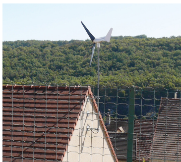
Éolienne individuelle en toiture.
