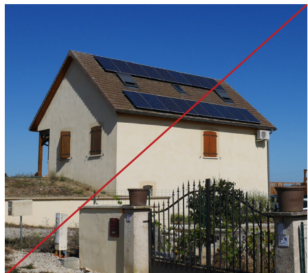
Panneaux solaires et châssis de toit non intégrés et très visibles depuis la rue.
