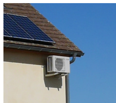
Bloc de climatisation.
