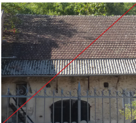
Multiplication de matériaux sur une même toiture (tôle et tuiles).
