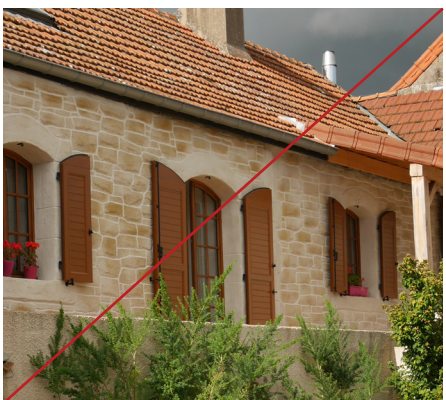
Parement industriel de fausses pierres; l'aspect est très impactant vis-à-vis des constructions alentour.
