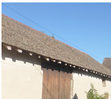
Forjet sur un bâtiment agricole.
