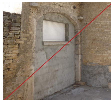
Insertion d'une nouvelle baie sans tenir compte de l'ancienne porte.
