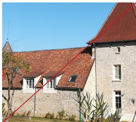
Lucarnes passantes rampantes à proscrire dans le bâti ancien.
