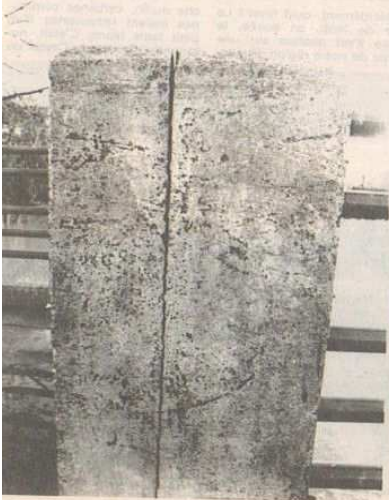
Fissure au pont Saint-Pierre.
