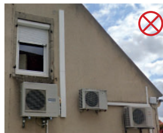
Store, menuiserie, coffret et éléments techniques nuisibles sur la façade. Il serait préférable d'avoir une menuiserie et un store de couleur plus sombre ou d'une autre matière que le PVC. Le coffret du store devrait être intégré à la maçonnerie ou positionné derrière un lambrequin. Puis les éléments techniques pourraient être regroupés de manière plus discrète pour ne pas surcharger la façade
