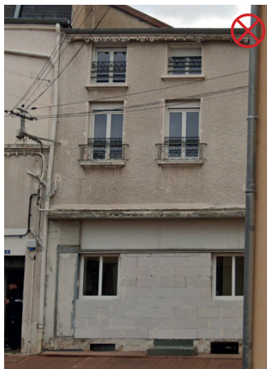
Bouchage du rez-de-chaussée et création d'ouvertures qui sont en rupture avec le rythme de la façade. Absence de revêtement
