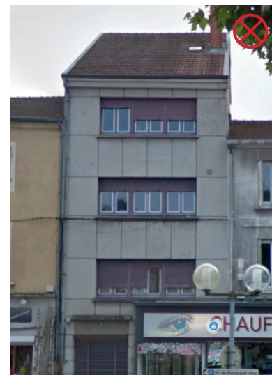
Fenêtres en bandeau qui ne correspondent pas aux façades traditionnelles, et revêtement terne
