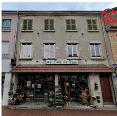
Présence de volets roulants qui surchargent les baies de par leur couleur trop blanche et leur position non intégrée à la maçonnerie
