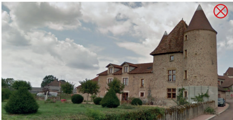
Revêtement inadapté au pied de la tour du Château de Grandvaux à Varennes-sous-Dun
