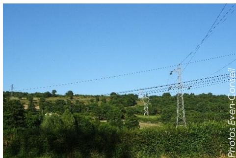
Pylônes et lignes haute tension, Montluçon
