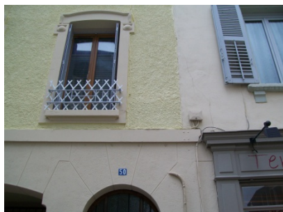
Enduit prêt à l'emploi inadapté !
