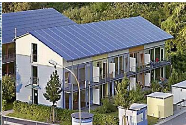
Panneaux photovoltaïques sur la totalité d'un versant
