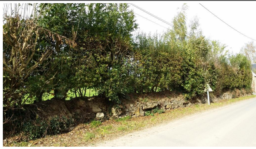
Mur le long de la Voie communale n°2 Le Bourg, parcelle ZD0135
