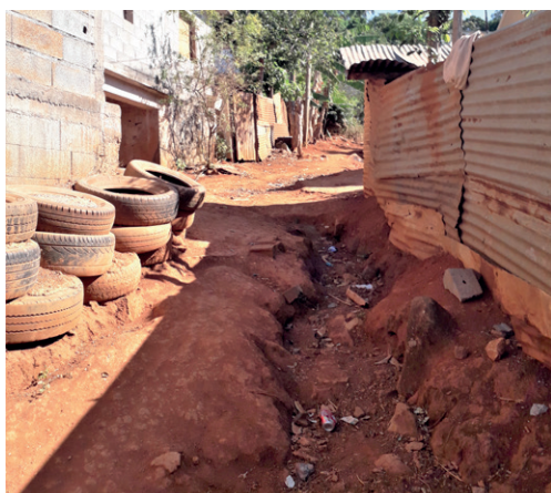
DÉGÂTS CAUSÉS PAR L'ABSENCE DE RÉSEAU PLUVIAL Cittànova - 2019
