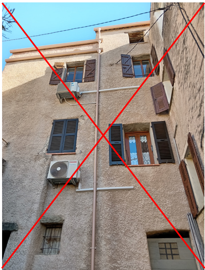
Les moteurs de climatiseurs doivent être intégrés à la façade : dans ce cas, la suppression des allèges des fenêtres aurait pu être l'occasion de créer des niches pour l'unité extérieure, afin qu'elle ne soit pas en saillie.
