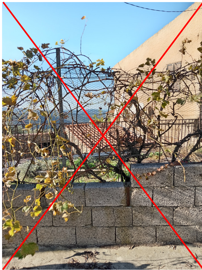
Si la végétalisation du grillage fin par les plants de vigne est une excellente idée, la réalisation du mur-bahut en parpaing sans enduit et présentant des redents nuit au patrimoine villageois. A minima, la réalisation d'un enduit similaire à la construction principal doit être réalisé.
