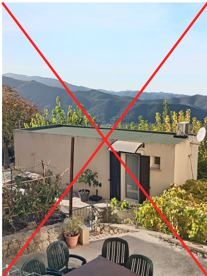
Toiture en terrasse inaccessible couverte d'une étanchéité apparente (proscrit sur la commune) et dont la couleur verte entre en contraste avec la couleur de l'enduit de la construction et s'intègre peu à la palette végétale environnante.
