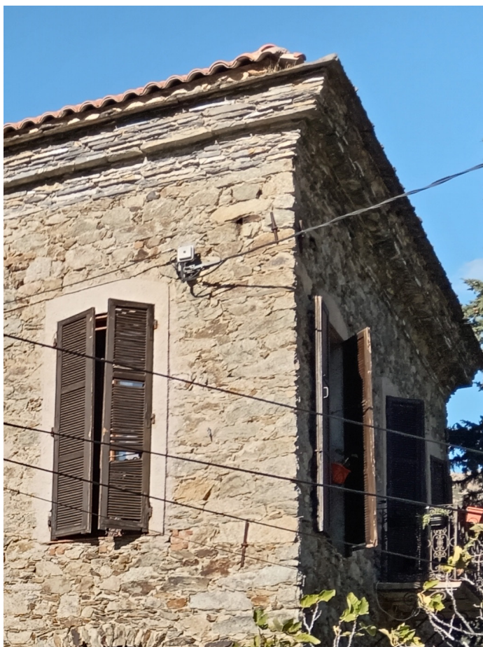
Détail de corniche à la génoise dont l'enduit n'a pas été réalisé ou est tombé avec le temps
