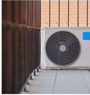
L'installation d'une unité extérieure sur un balcon, derrière le garde corps est un choix bien intégré
