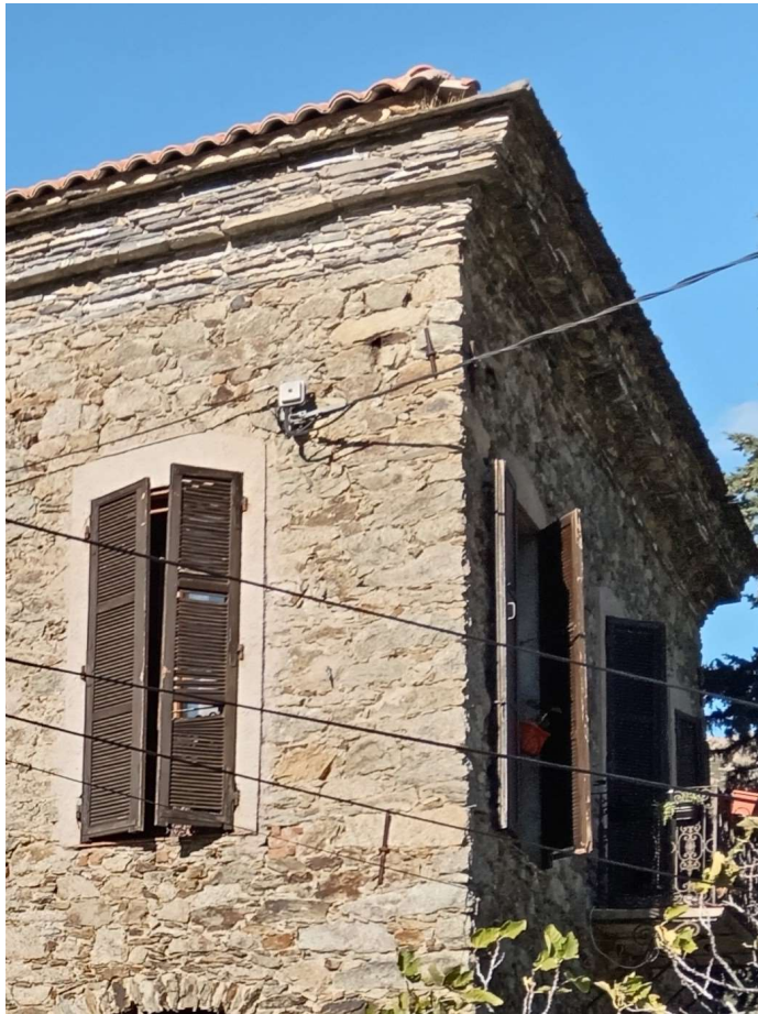
Détail de corniche à la génoise, en schiste, dont l'enduit n'a pas été réalisé ou est tombé avec le temps
