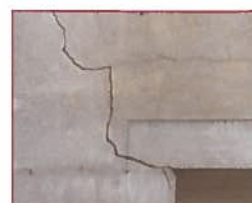
Enduit* ciment sur une maçonnerie ancienne : fissurations
