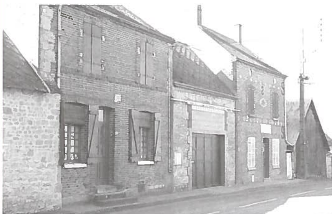
Avant : baie dénaturée (partiellement remplie en parpaings).
