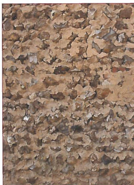
Maçonnerie en silex dégarnie.
