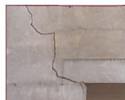
Enduit* ciment sur une maçonnerie ancienne : fissurations
