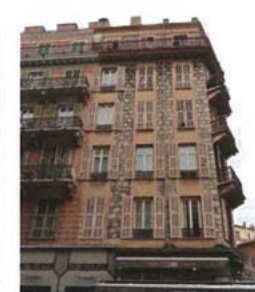
Enduits d'origine supprimés
