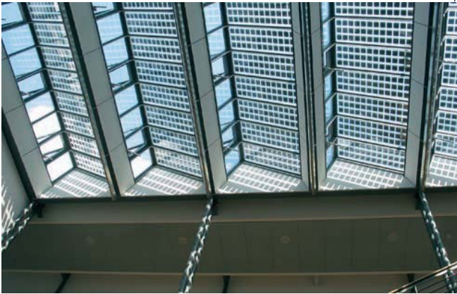
Mairie de Paris : cellules photovoltaïques en verrière
