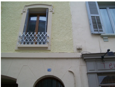
Enduit prêt à l'emploi inadapté !
