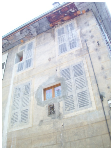
Façade en trompe l'œil (altérée)
