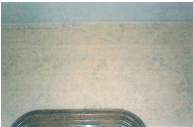
Fissuration intérieure, tapisserie déchirée - Maison André.
