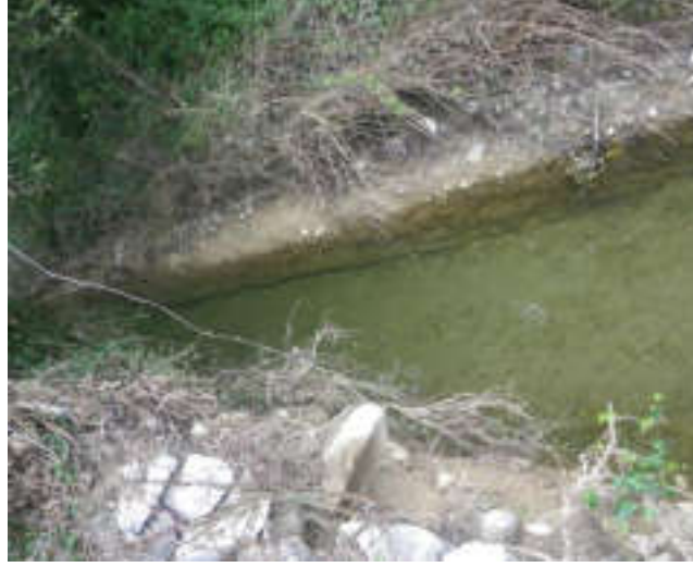
Fond ou lit du ruisseau en droit de la berge emportée. Incision, absence de matériaux, affouillement des pieux de berge
