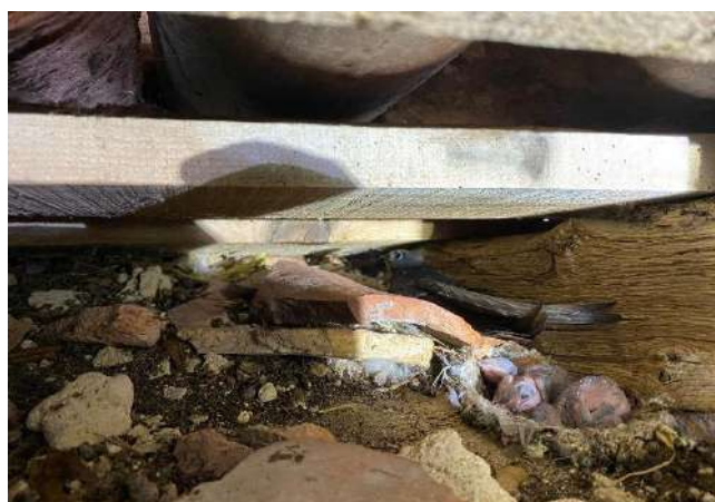
Nid de martinets sous les toits @L. PRATS ETEN Environnement 2022
